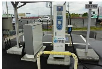
EV 充電器(小型エリア)
