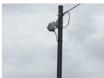
ETC2.0 通信アンテナ
