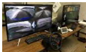
遠隔監視・操作装置(1台用例)
