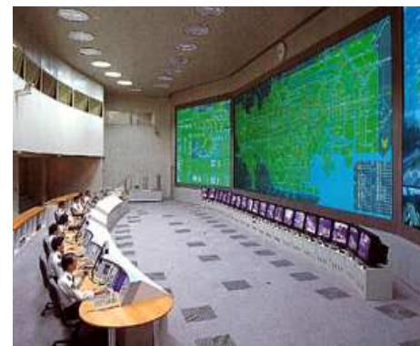
交通管制センター
