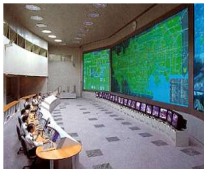
交通管制センター
